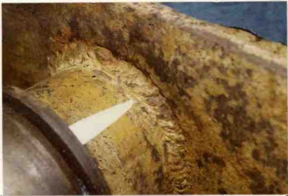
Foto III. Verbindingslas van roerkoning met het roer (met roestschillen).
